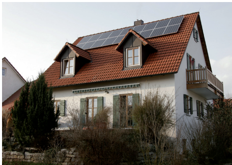
Abb. 6: PV-Anlage auf einem freistehenden Gebäude.
