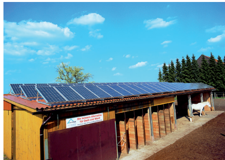
Abb. 8: PV-Anlage auf landwirtschaftlich genutztem Gebäude.
