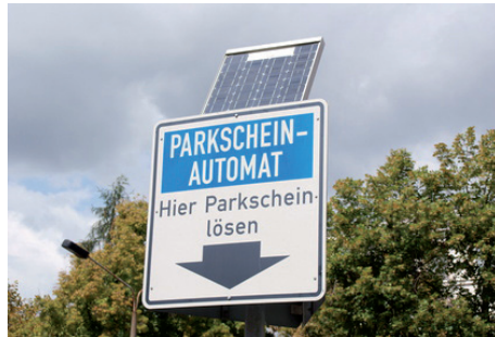
Abb. 12: An der Größe des einzelnen Moduls lässt sich erkennen, dass hier nur sehr wenig Energie benötigt wird. Das Gleichstromsystem eines Parkscheinautomaten ist in etwa mit dem eines KFZ vergleichbar.
