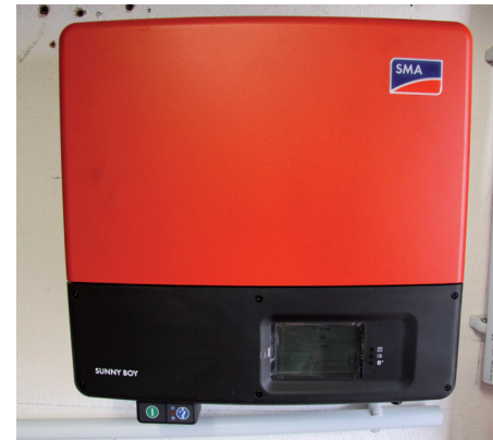
Abb. 19: Wechselrichter können, je nach Gebäudesituation, wie hier im Hausanschlussraum oder aber auch an anderer Stelle installiert sein. Links unten ist ein integrierter DC-Freischalter zu erkennen.
